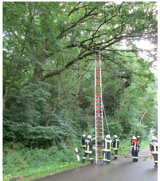
Lose Äste auf der Gemeindestraße zwischen Maiszagl und Unterschwillach galt es auch im Jahr 2016 zu beseitigen.
